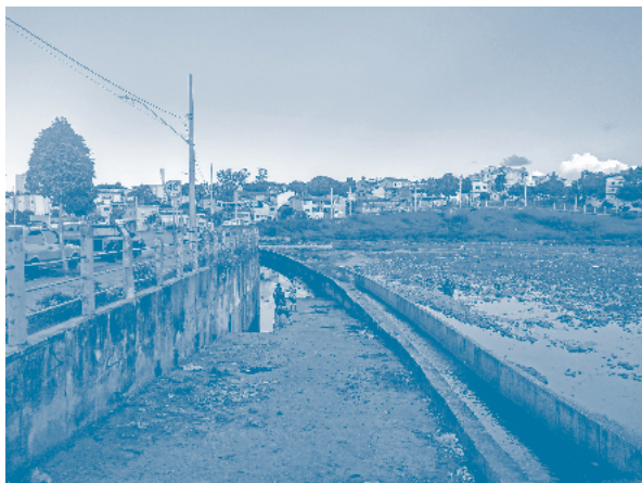
Célula 2, vista a partir da av. Várzea da Palma: lama e empoçamentos após eventos pluviométricos, e crianças junto às estruturas de controle e descarga
